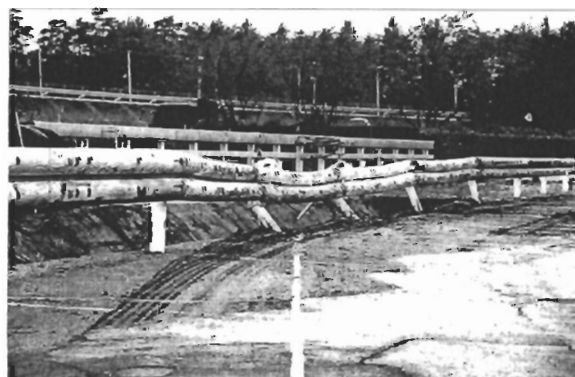
写真-1 防護柵の残留変形状況
